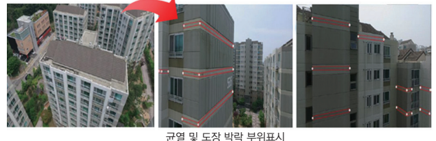
그림 3. 건물 안전진단 및 하자조사 사례
